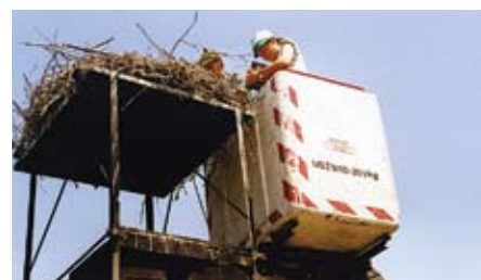
Platforma gniazdowa na kominie w Halembie
